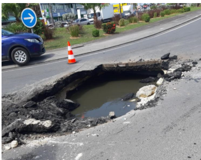
Figure 31 : Affaissement de la chaussée rond-point haricot à Jarry en février 2021 (source : Canal 10)
