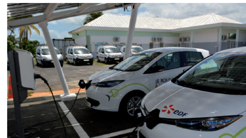
Bornes de recharge des voitures électriques - dispositif DRIVE
