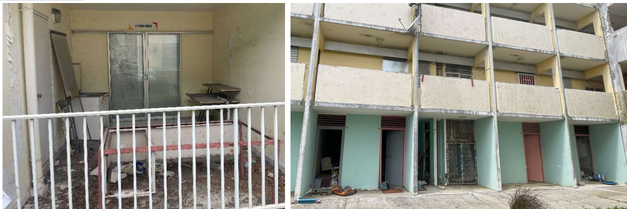
Figure 138 : Déchets entreposés au rez-de-chaussée des immeubles du quartier du Morne. Source : FILAO Ingénieurs Conseils
