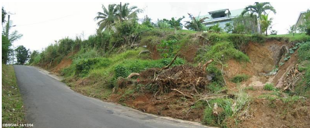
Figure 17 : Glissement du talus routier au lieu-dit Chapelle Calvaire (fiche BRGM N° 12400085) [Source : BRGM]
